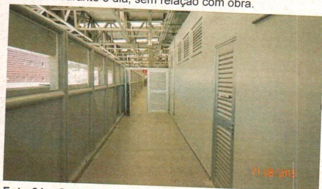
Foto 21 – Salas operacionais no mezanino.
