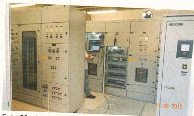
Foto 22 – Interior das salas técnicas.
